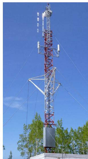
Une station de service cellulaire 4G installée en 2014 à Wrigley.
